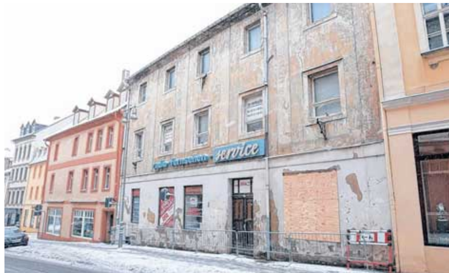
Streitobjekt: Nach hitziger Debatte hat der Stadtrat grünes Licht gegeben, um den Abriss des stark baufälligen Hauses in der Johannisstraße 49 zu planen. Foto: Mario Jahn
